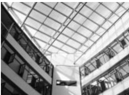
Abb. 8: Blick auf das Atriumdach von Innen. Die Folienrollen sind geschlossen. Die hellen Eckfelder besitzen keine Rollos.
