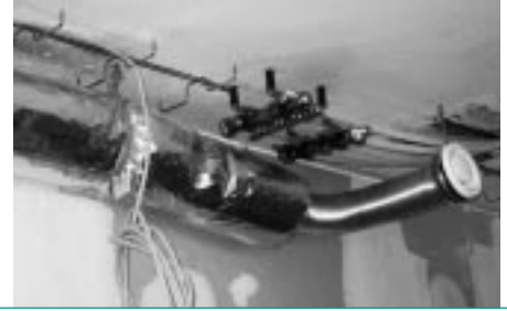
Abb. 7: Luftabsaugung mit Schalldämpfer sowie Hydraulikgruppe der Betonkerntemperierung in einem Büroraum (vor der Verkleidung).
